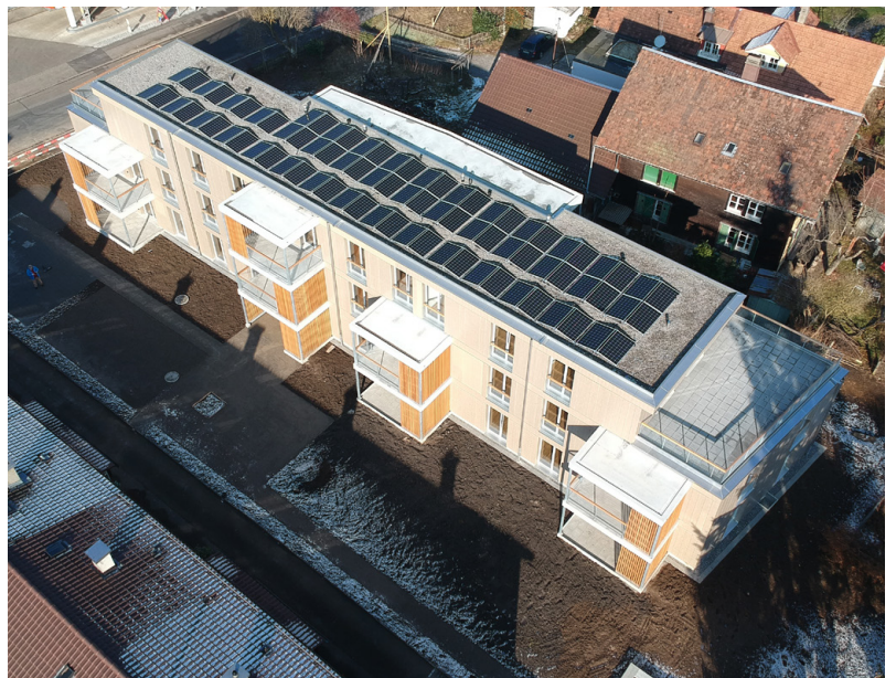
Photovoltaikanlage auf dem Flachdach
