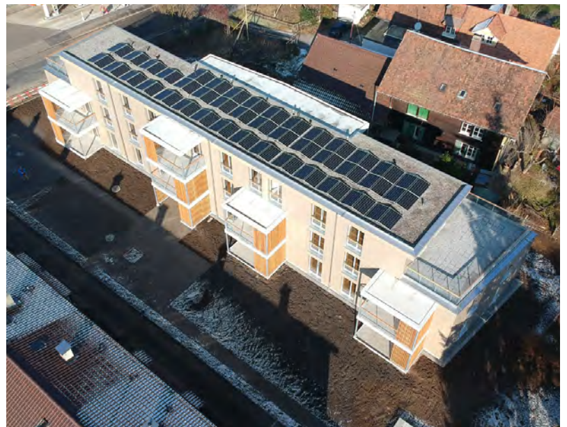
Photovoltaikanlage auf dem Flachdach
